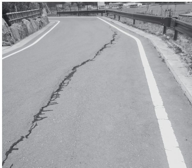
西区公園付近 破断約10mの現況
