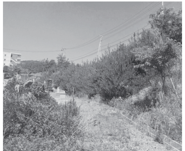
法面が崩れる前に対策を
