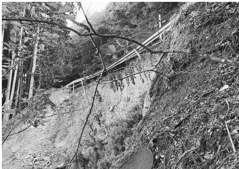
台風19号で崩落した高白付近の県道
