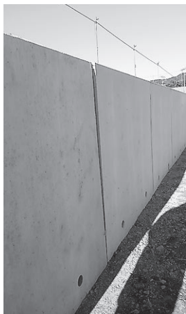
擁壁に「目ちがい」が発生
