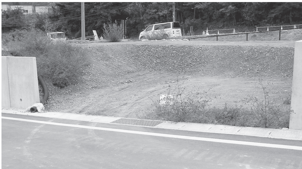
段差が大きい駐車場（荒立西区）
