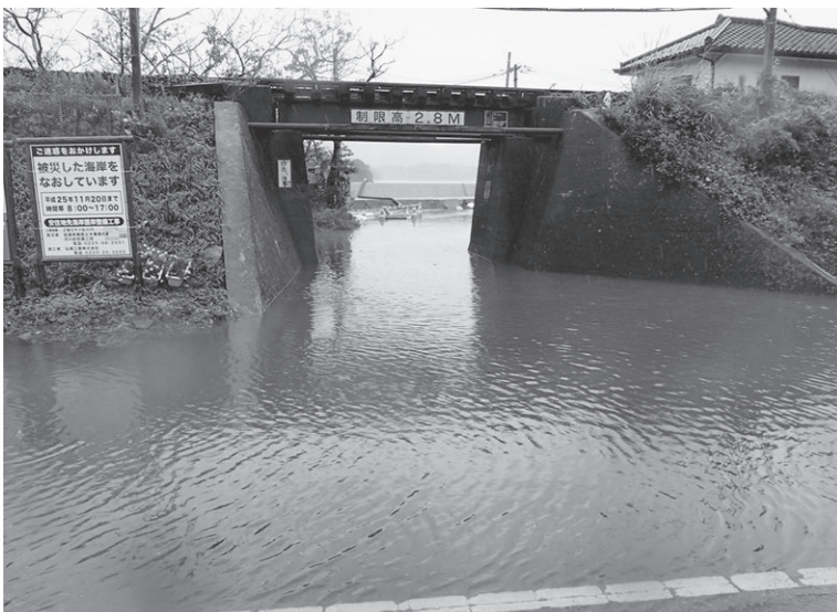
台風26号でいたるところが冠水(安住地区)
