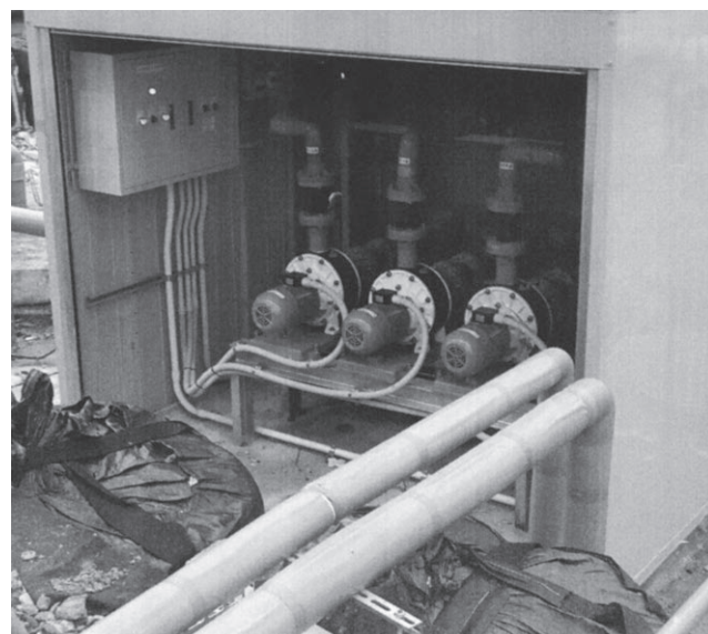
海水供給設備
